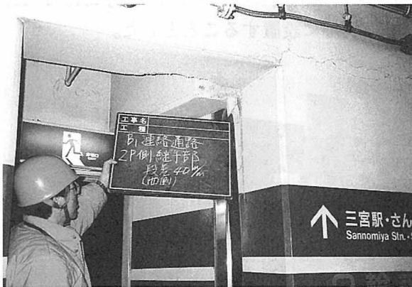
写真19-1-5 第2駐車場と連絡通路の取合い部の鉛直変位（40mm）
