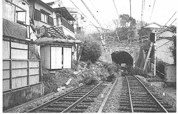
写真19-5-6 被災した法面（湊川～長田間1 K 370 M 付近）
