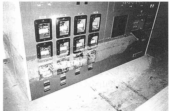
写真19-1-7 第2駐車場監視盤の水没
