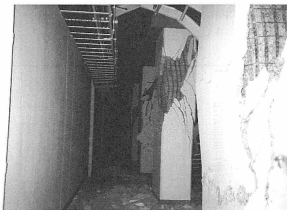
写真19-4-2 破損した駅舎内中柱
