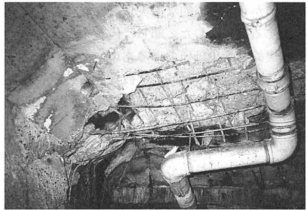
写真19-1-6 No.3給気塔スラブのコンクリート剥落
