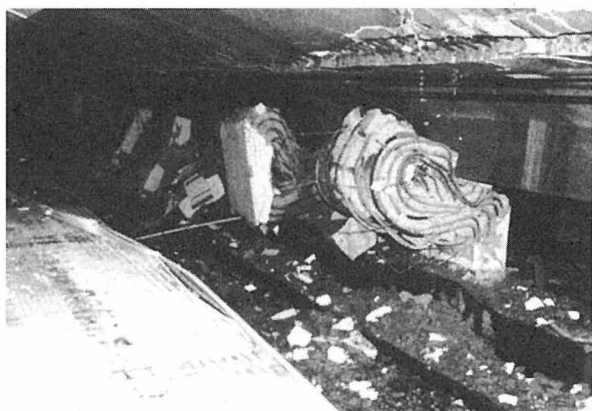
写真19-5-12 圧壊した大開駅の間中柱
