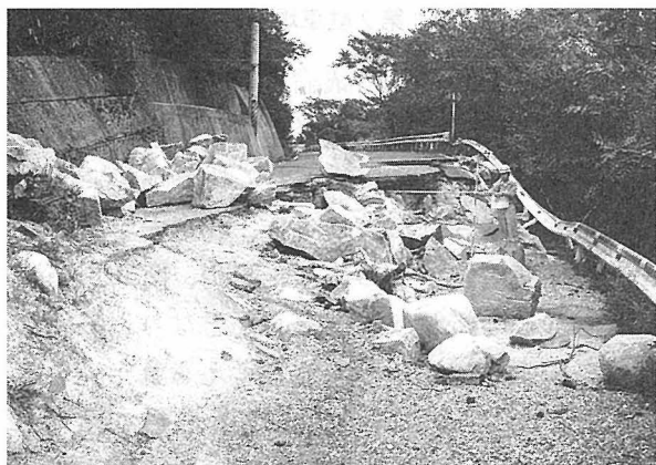
写真19-1-8 明石神戸宝塚線陥没状況
