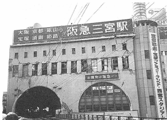
写真19-5-2 三宮駅ビル被災状況
