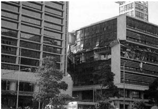
6階部分が崩壊した神戸市役所2号館
