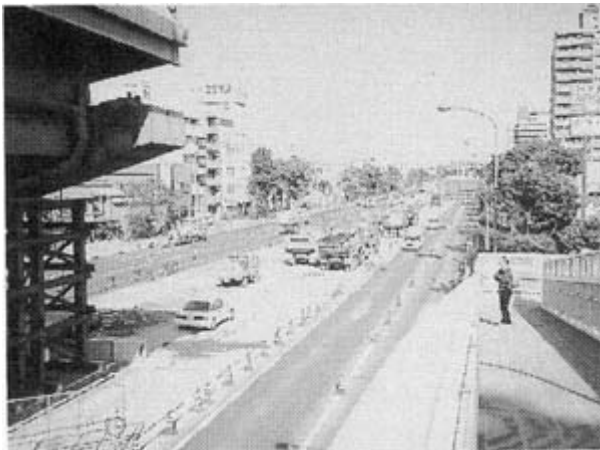
途切れた阪神高速道路 （横転した高速道路を除去整地した後 東灘区深江付近 平成7年1月29日撮影）
