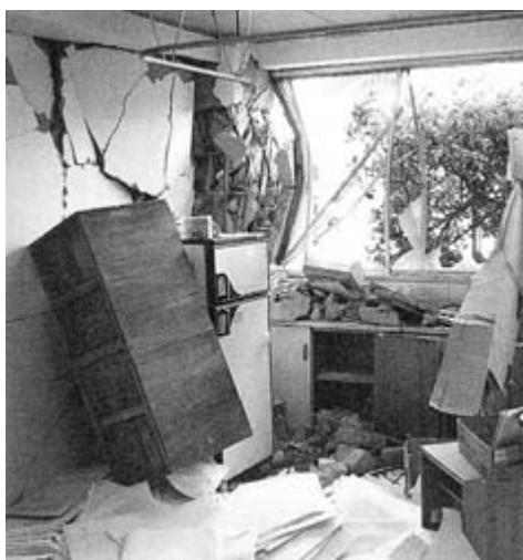
せん断破壊された外来診療所の柱 (平成7年6月15日撮影)
