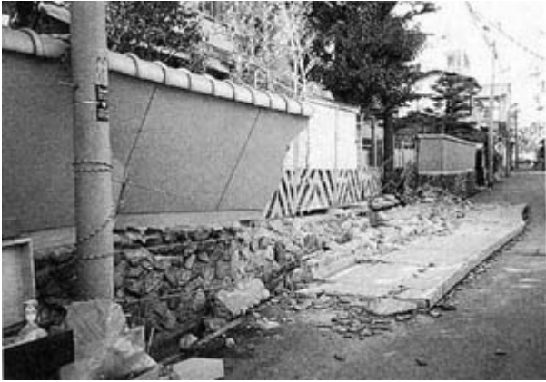
崩壊した当院北側の堀 （平成7年1月30日撮影）
