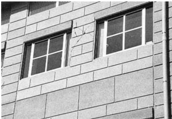
外壁に地震で生じた亀裂（平成7年1月17日撮影）
