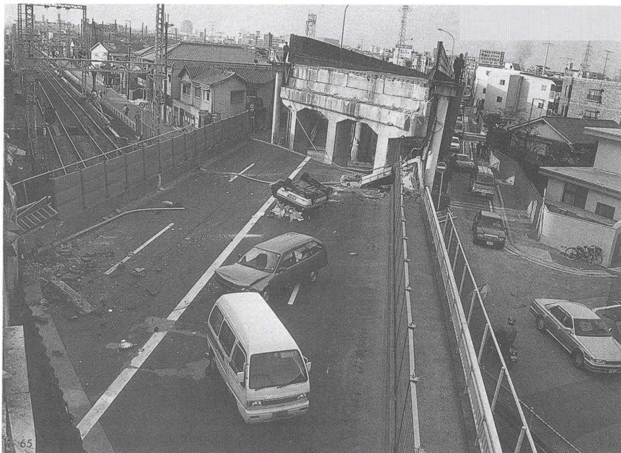
▼国道171号線の陸橋が落下 ●浜屋 西宮店 前を西へ50m
