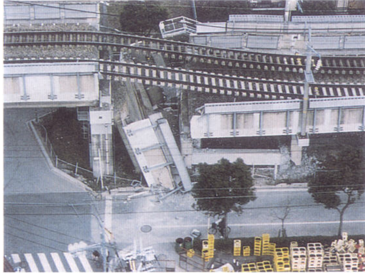
A. 新幹線高架橋の落下（地点：尼崎市下食満付近）
