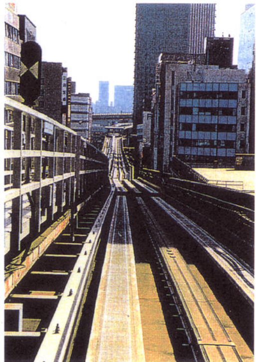
M. 神戸新交通ポートアイランド線 (桁ずれによる橋面の状況)
