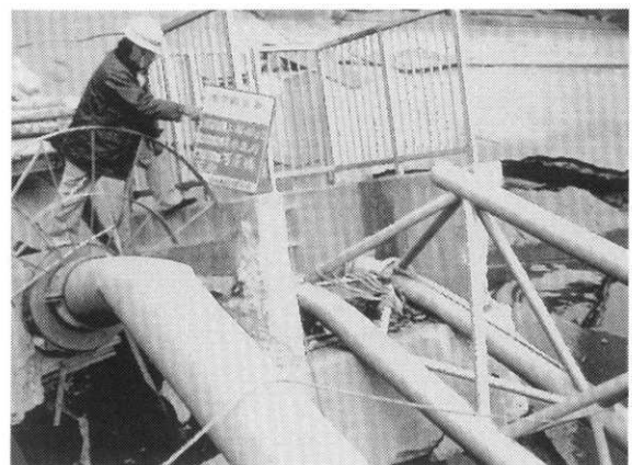
写真-4 苅藻橋橋台転倒による損傷
