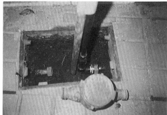
写真-2 栓立ボックス内(メーター取外し)
