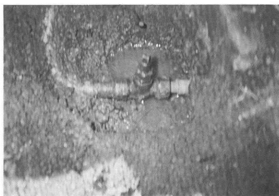
写真一四 止水栓漏水、コマにて止水あり
