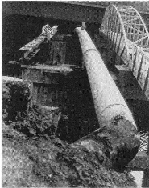
写真一七 高羽大橋東沓破損横移動
