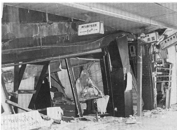
写真-1 神戸市三宮駅前倒壊現場
