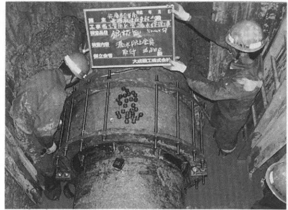
写真-6 φ800ヒューム管と鋼管の継手部漏水、鋼板製漏水防水金具にて補修
