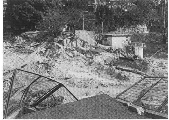
写真-4 西宮市水道局ニテコ貯水池堰堤崩壊現場
