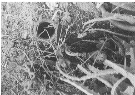
写真一三 止水栓故障（開にても水出ない）
