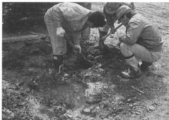
写真一八 整地内漏水における給水管止め、 位置不明調査掘削
