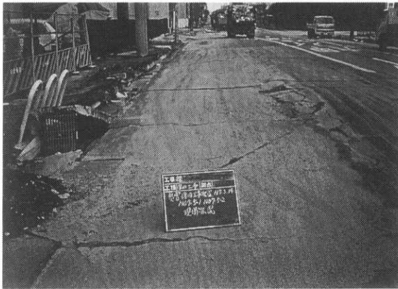
写真-3 震災時の路面状況
