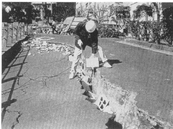
写真-5 岸地橋背面護岸の沈下
