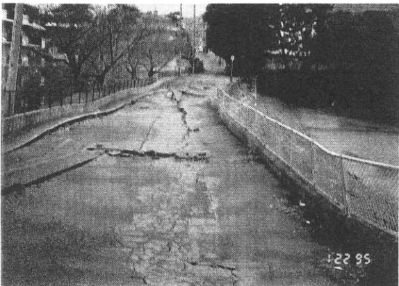
下池堤体破壊状況
