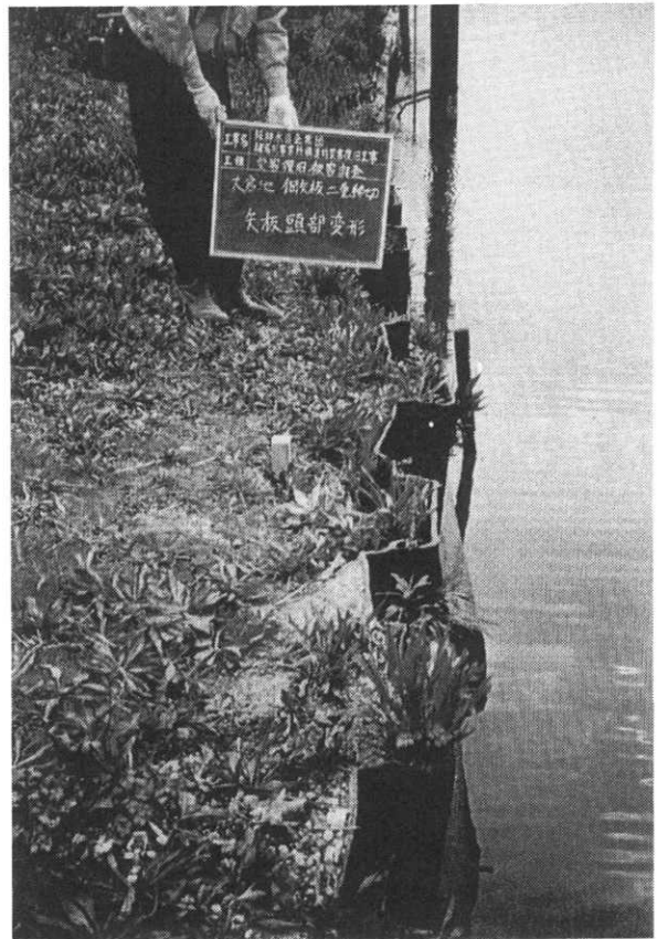
写真4-4 護岸鋼矢板の変形
