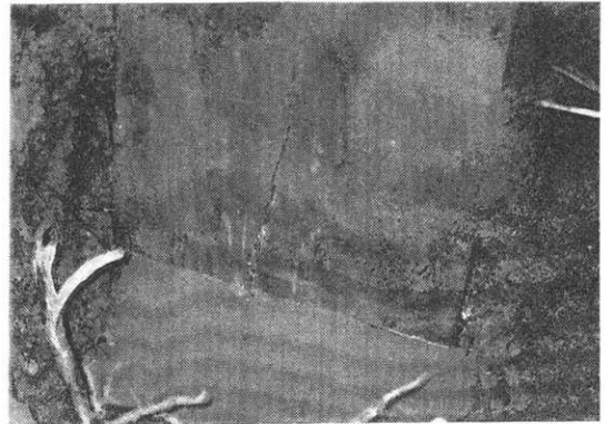
池外断裂損傷状況（浄水漏水）
