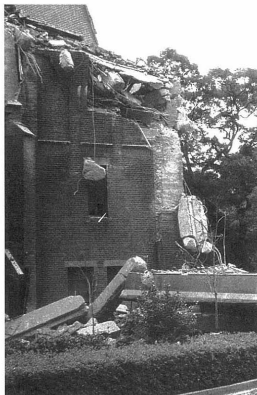
倒壊した礼拝堂
