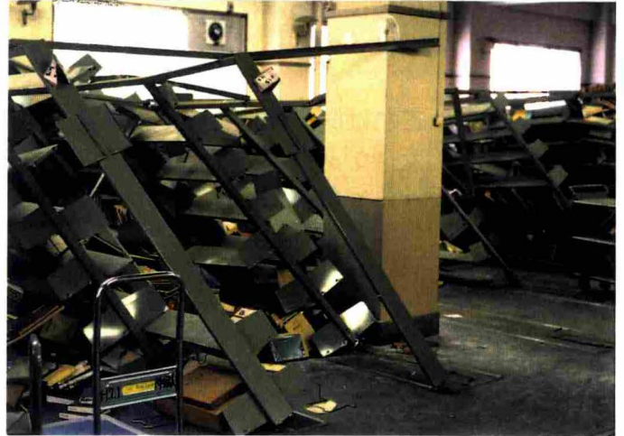
倒れ方の状況（書庫） 固定の仕方に問題（図書は取り除いている）
