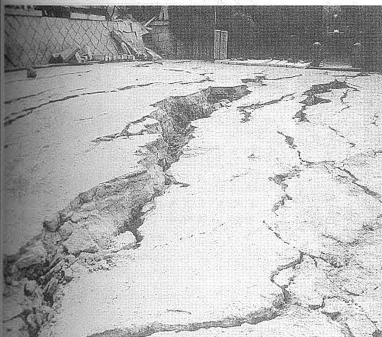
野島八幡神社境内は、野島活断層の影響のため地割れが激しい
