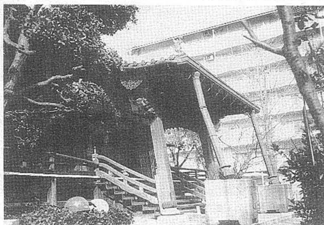
神戸市長田区の本願寺派金楽寺では、本堂も庫裡も斜傾して、使用不可能な状態に。復旧活動には時間がかかりそう
