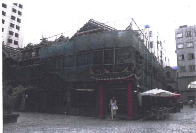
▲写真 2 成都市基督教青年会の修復の様子（建物の一部にひびが入っている。7 月 12 日見学。）
