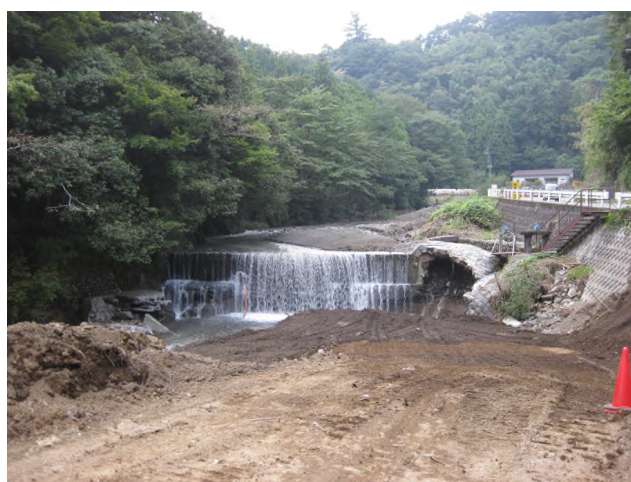
▲皆瀬川地区の護岸被害。 (神奈川県豪雨被害調査にて) (2010年9月 20日、宇野淳子氏撮影)
