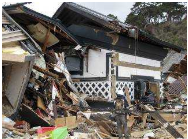
がれきを受け止めた土蔵 (石巻市街地)
