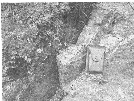
西宮市南部 N-2 甲陽園神山町 甲陽断層付近の岩石は破碎され 崩壊が生じている。
