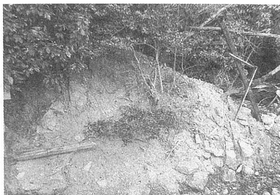
芦屋市 A-16 苦楽園 崩壊によって斜面上部の樹木が 倒壊している。
