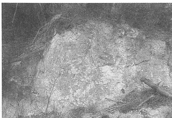
芦屋市 A-10 山芦屋町 芦屋断層付近の岩石は破碎され、 斜面下部に崩壊した土砂が堆積している。
