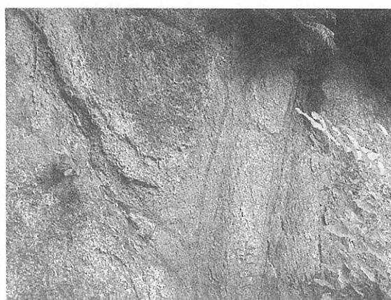
西宮市南部 N-3 甲陽園神山町 細脈に沿って崩壊が生じている。 斜面下部に崩壊した土砂が堆積している。
