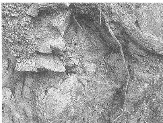
神戸市東部 K-4 岡本6丁目 節理に沿って風化が進んでいる 斜面は風化した花崗岩で構成されている。
