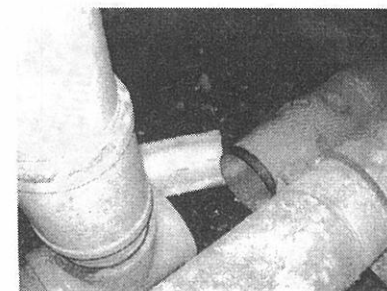
写真-11 高架水槽の接続管(J)
