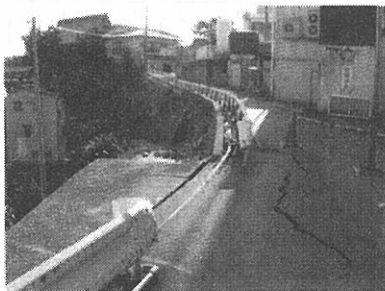
写真-7 受水槽までの道路損傷(J)
