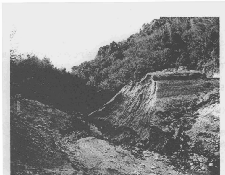
Fig.1 ため池堤体の破堤状況の一例(北淡町黒谷(五斗長): 新池)
