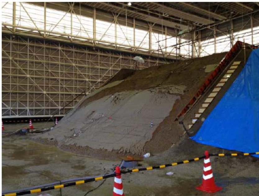
写真-4.2 斜面の崩壊状況 2)
