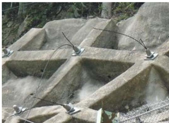
写真-1.1 アンカーが破断し飛び出した状況
