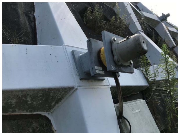
写真-2.1 アンカーの荷重計
