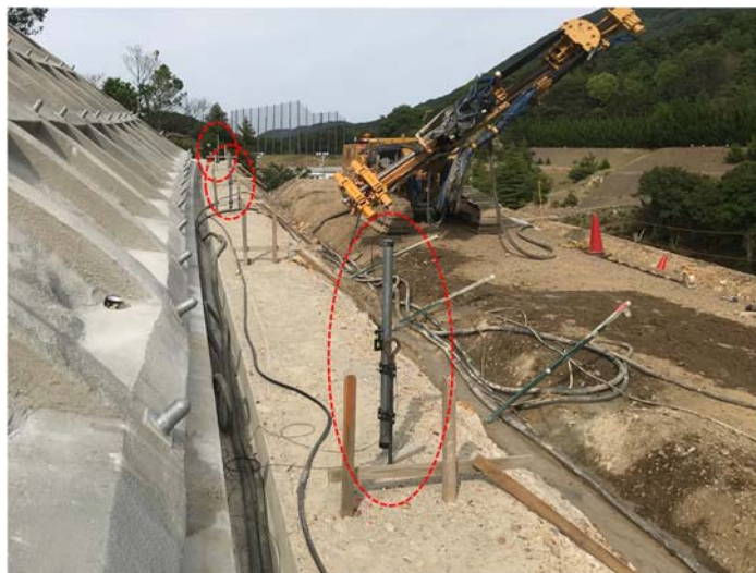
(b) 実際の現場への設置状況
