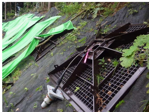
写真-2.2 破断し頭部が飛び出したアンカー
