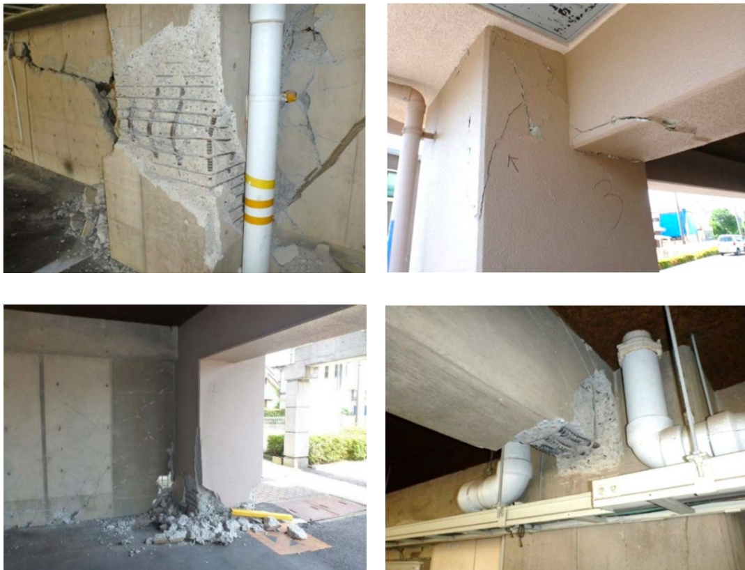
図－1.13 事例④ ピロティ層の構造部材の損傷（一部）[1-4]
