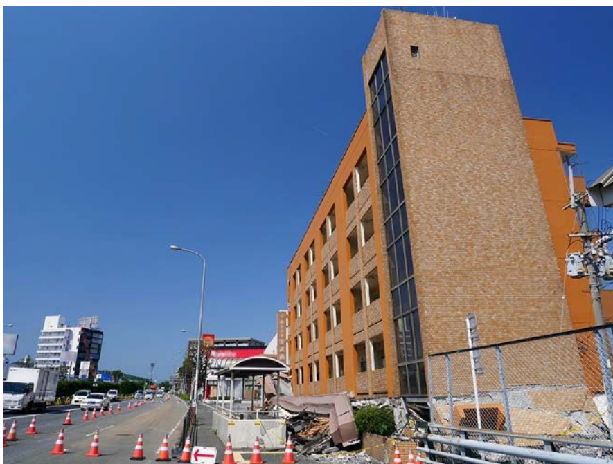
図－1.5 事例① 層崩壊した 1977 年築のピロティ形式集合住宅[1-4]
