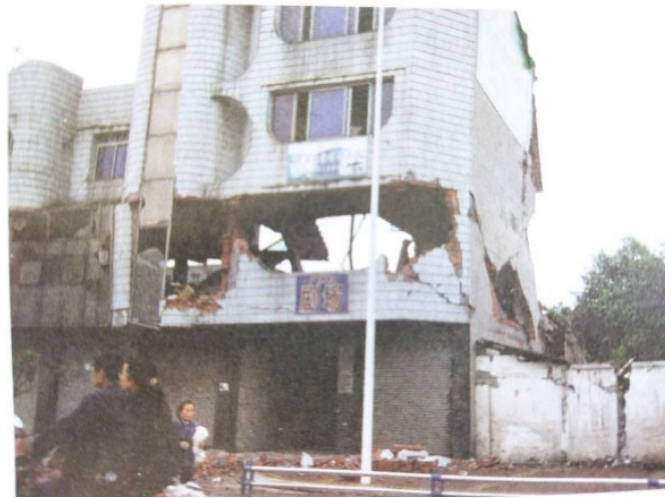
図－1.20 事例③ 2階が大破したピロティ形式建築物[1-9]
