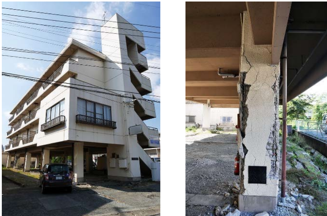
a) 全景 b) 柱の付着割裂 図-1.7 事例② 大破した1985年築のピロティ形式集合住宅[1-4]
