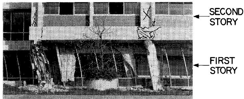
図-1.15 1階ピロティ層と2階の層間変形の違い[1-6]
