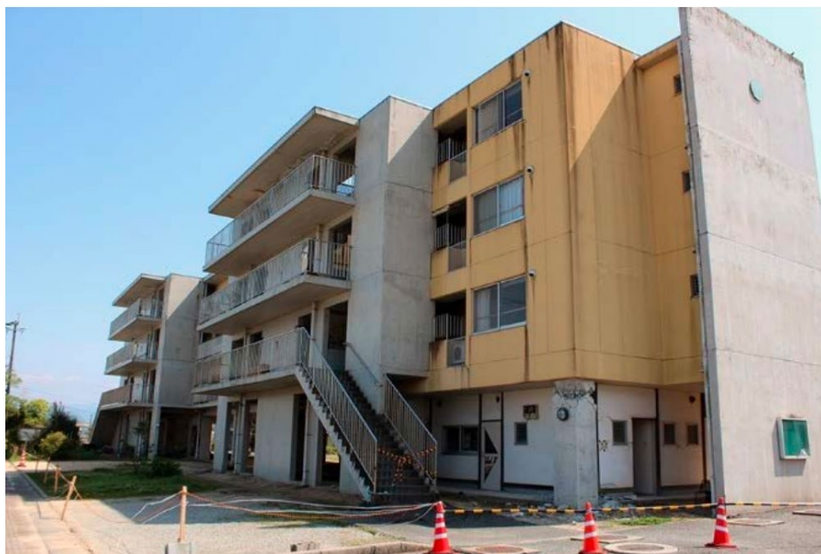
図－1.9 事例③ 大破した 1998 年築のピロティ形式の集合住宅[1-4]
