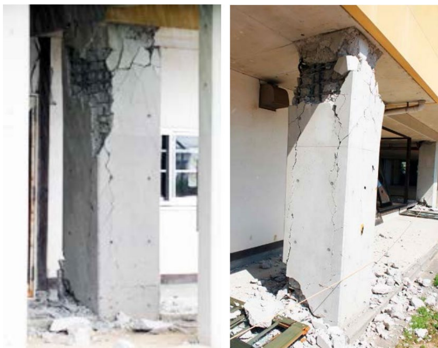
図－1.10 事例③ 付着割裂ひび割れが生じた柱[1-4]
