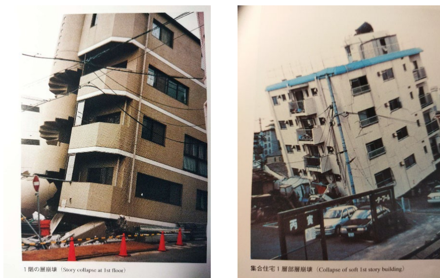
図-1.4 ピロティ形式集合住宅が1階で層崩壊を起こした事例[1-3]
