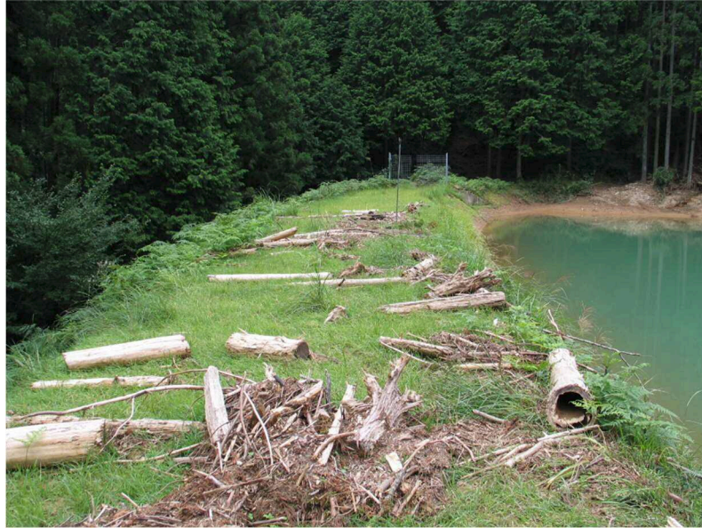
図 3-7 水上大池の被災後堤頂部（神戸大学 田中丸教授撮影）
