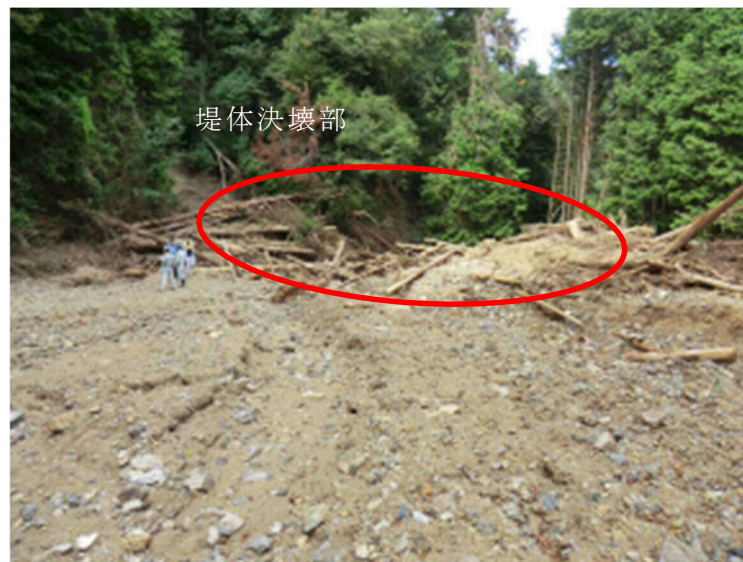
図 3-9 木古庵池の被災状況（上流側から見た堤体内，兵庫県撮影）
