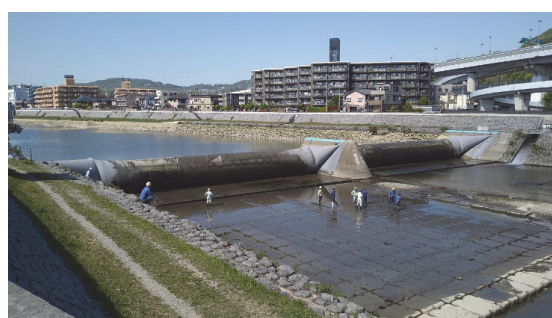
(b) 2023 年 4 月 27 日起立後(漏水噴出なし)
