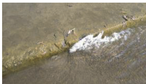
(b) 漏水噴出箇所(近景)
