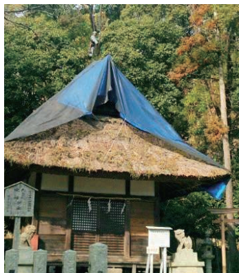
公智神社の損傷した文化財
