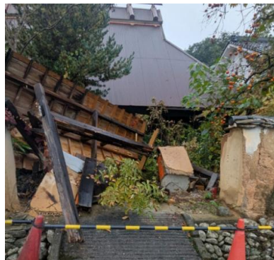
第 9 図 倒壊した武家屋敷の門 2025 年 11 月 9 日 林撮影
