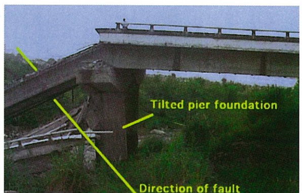
図-22 断層変位による橋梁基礎の破壊
