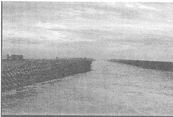
図-17 火力発電所の放出堰堤の変状
