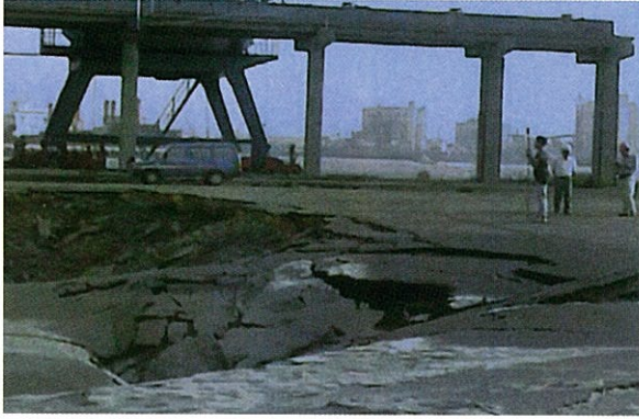
図-4 護岸背後地盤での液状化
