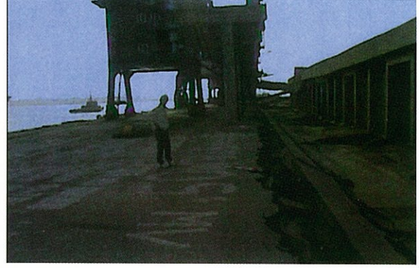
図-5 護岸背後の不等沈下
