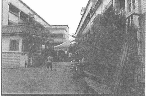
図-12 北端（右）マンションの傾斜 （BブロックからAブロック向き）
