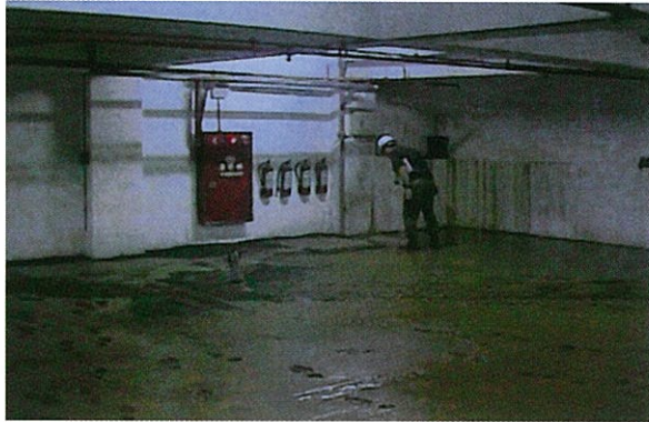
図-9 Aブロック地下駐車場の液状化
