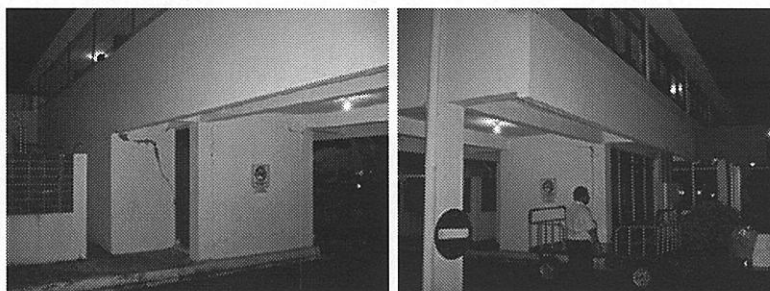
写真-1 Yogyakarta 空港ターミナルビルに発生したクラック
