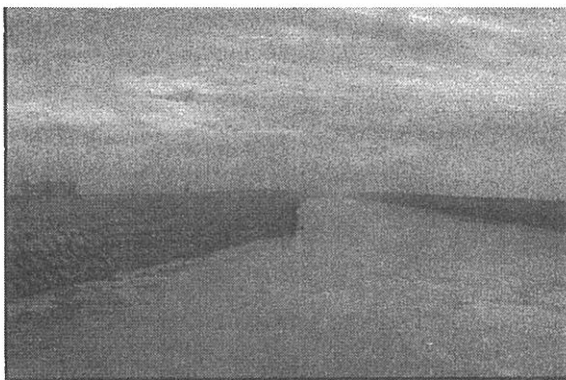
図-17 火力発電所の放出堰堤の変状
