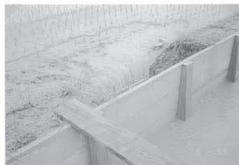
Fig.7 田植え期における溝畔陥没の発生 (2001/06/19)
