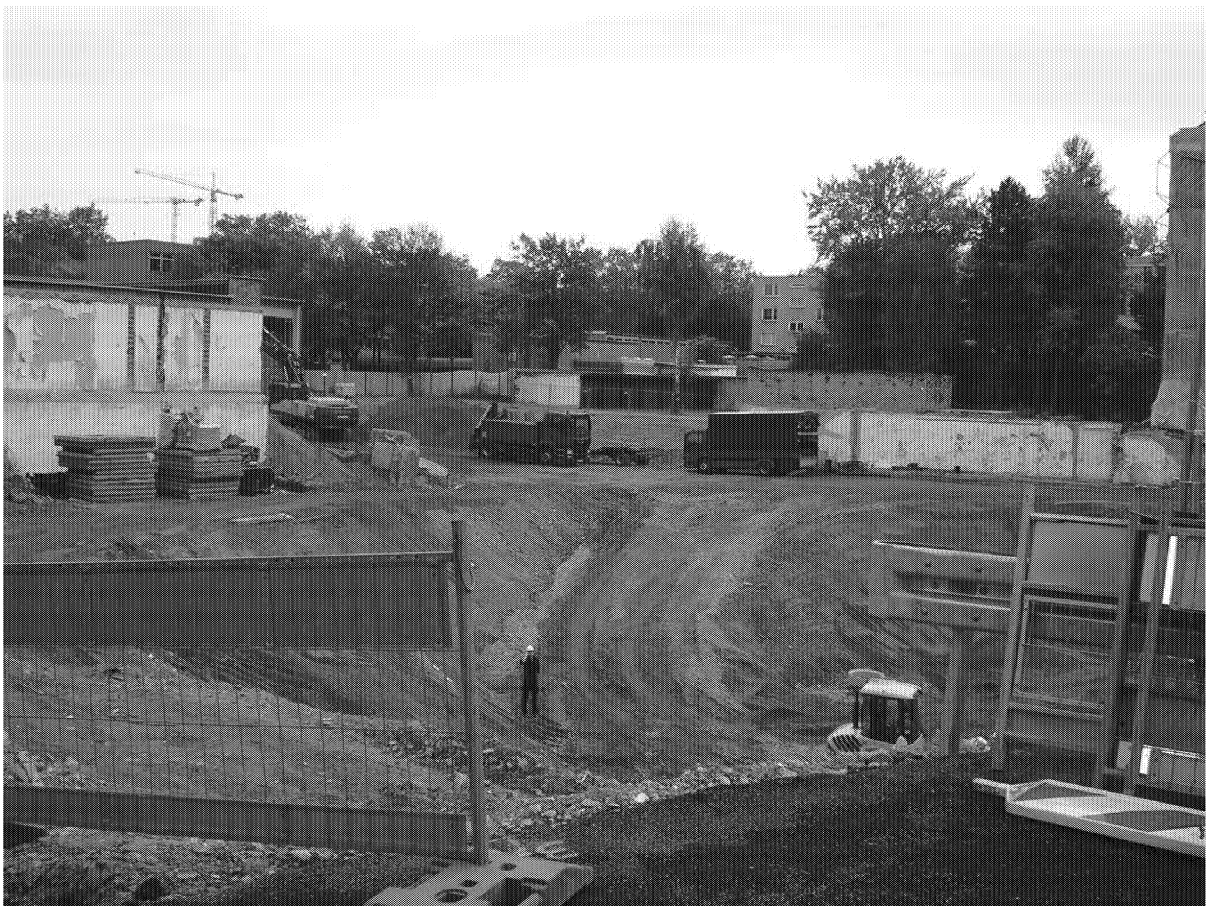
Es scheinen richtige Zufahrtswege in der vom Stadtarchiv übrig gebliebenen Grube des Stadtarchivs für Bagger und LKWs angelegt worden zu sein. Die Tiefe der Grube scheint etwa 10 Meter zu betragen.
