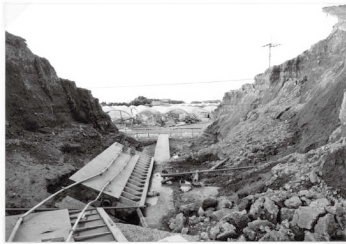
Fig.16 決壊した堤体を貯水池側から見た様子(1997年3月3月27日)
