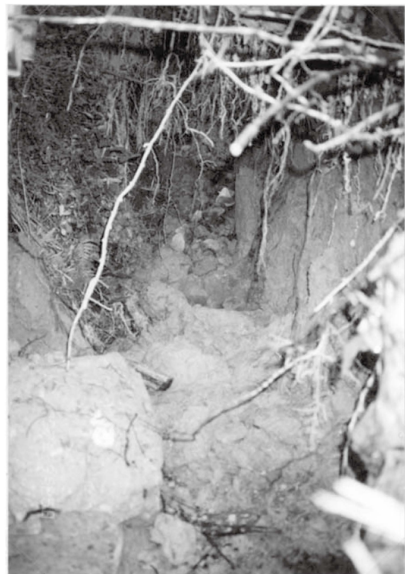
Fig.25 底樋の左側におけるパイピング孔 (右側に底樋がある)
