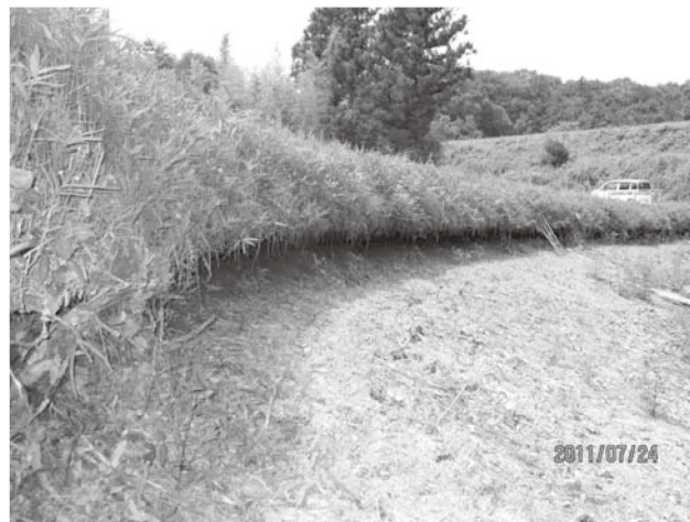
Fig.40 波浪によって浸食された上流側斜面 (人谷中池)
