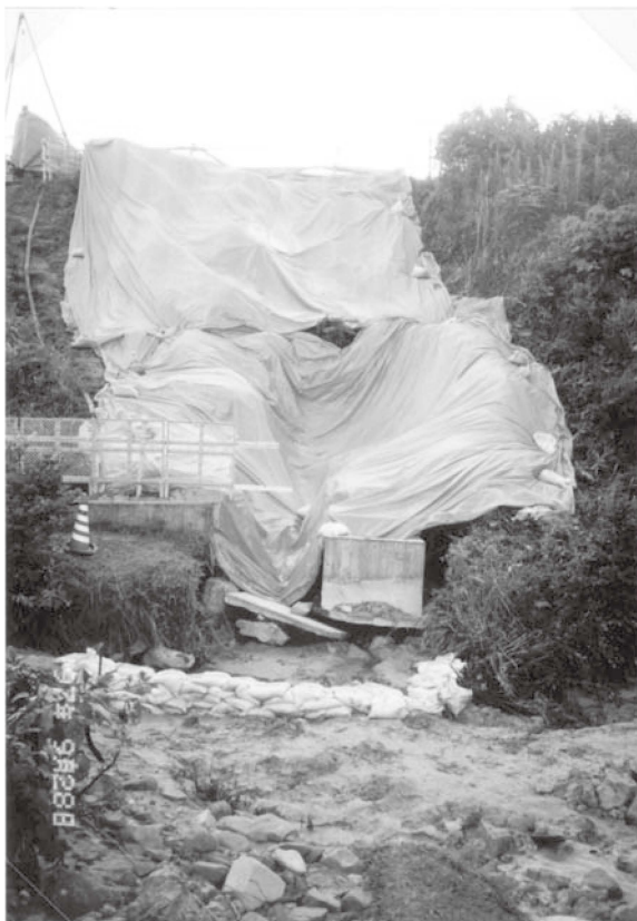
Fig.24 破堤した宝谷池堤体 (下部に底樋が見える)
