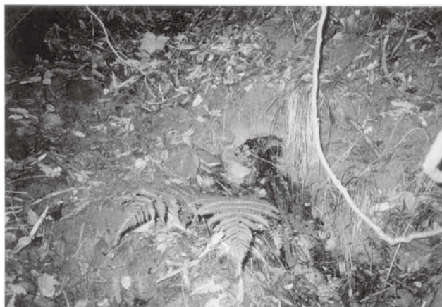
Fig.30 進行性法くずれの下部写真 (水の集中した流れとパイピング孔がみえる)
