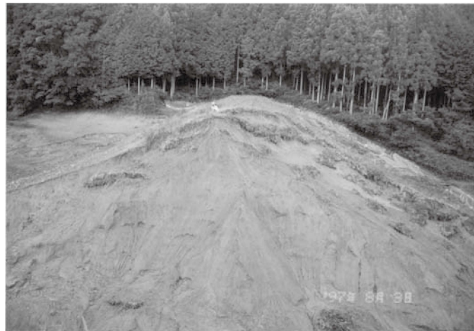
Fig.21 麻生ため池決壊部分の近接写真(1997年8月3日) (堤体にはマサ土が盛立てられている)
