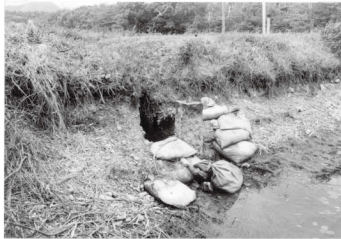
Fig.27 トクベール中池堤体のパイピング孔
