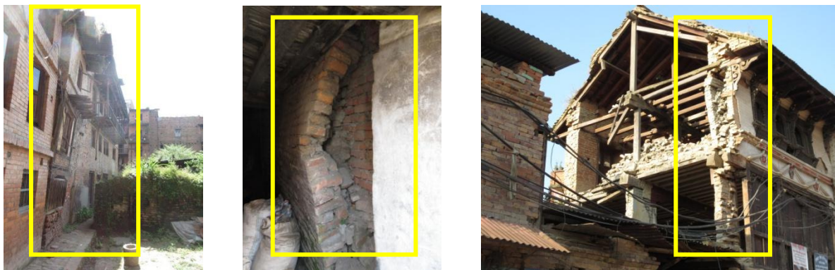
(a) 耐力壁の損傷例 1
