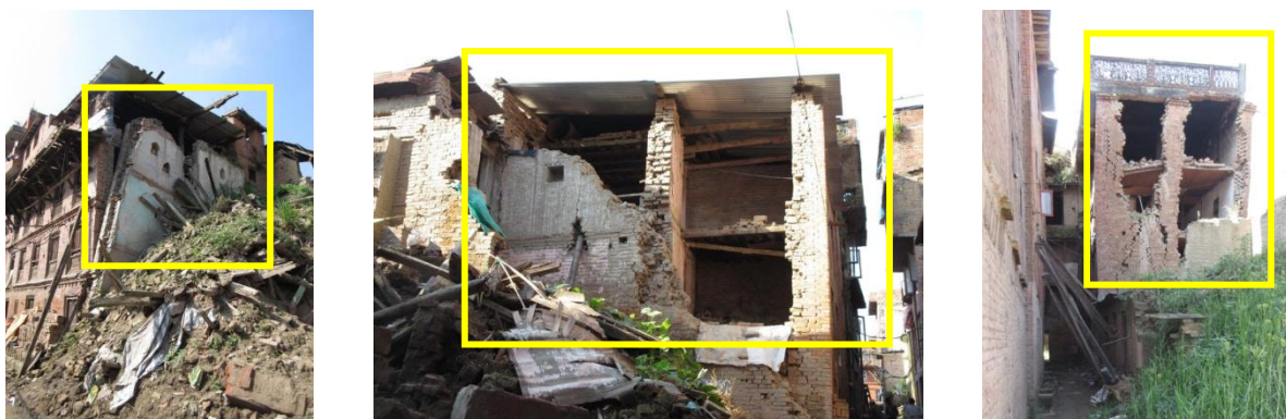
(a) 妻壁の損傷例 1
