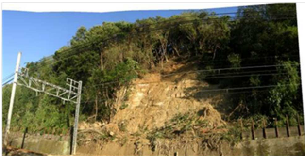
写真-1 崩壊斜面の状況
