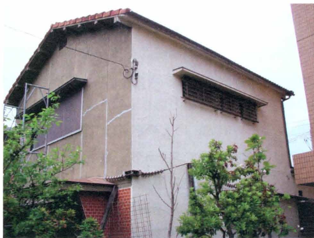
写真-5.1 ISH邸の外観（兵庫県南部地震時に壁面に発生したクラック跡が確認できる）
