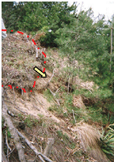
写真 5-11 急勾配斜面の表層崩壊形態 (表層崩壊の進行が確認できる)
