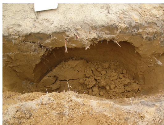
写真 5-14 崩壊後のテストピットの状況(1)
