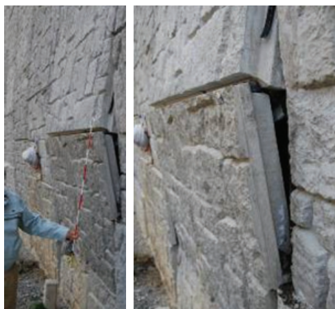
写真 5-3 変状箇所における壁面工の状態
