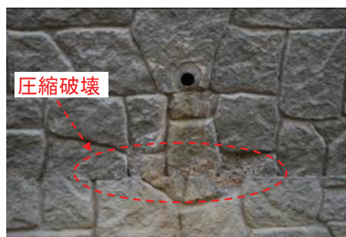
写真 5-4 壁面工の圧縮破壊の様子
