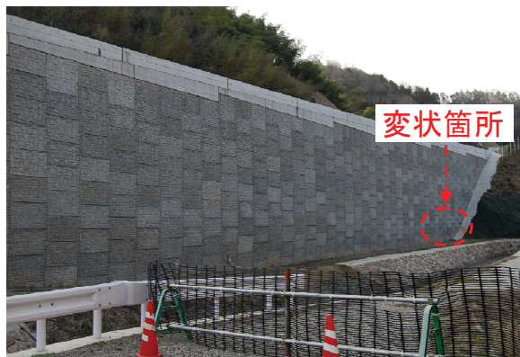
写真5-1 当該補強土壁工の全体像と変状箇所
