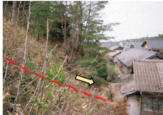
写真 5-8 住宅地の背後における急勾配 斜面の状況(斜面崩壊土砂が家屋に接近 している)
