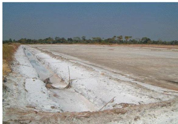
図-7.1 塩類で侵された農業用水路
