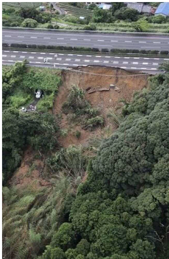
写真 4.1 2009 年 8 月 11 日 5 時 7 分発生 駿河湾地震 盛土が崩落した東名高速道路：東名高速道路 牧ノ原サービスエリア付近 毎日新聞HPより
