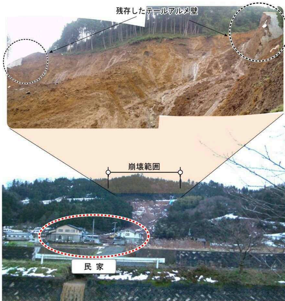
(a) 崩壊した補強土壁
