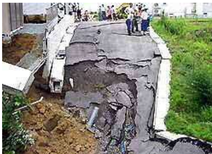
写真 3.3 みがき砂採掘跡地の陥没 14)
