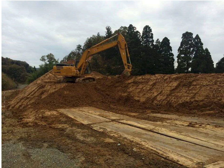
写真 4.2 切土掘削後に土を仮置きした状態（試料 No.1 として採取）
