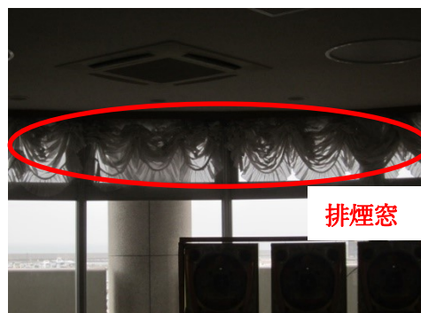
図2-5 窓上部の排煙窓にカーテンを設置した事例 (特養①)
