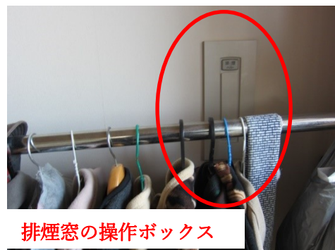
図2-6 居室内の排煙窓の操作ボックスの前に物品が置かれた事例 (特養②)
