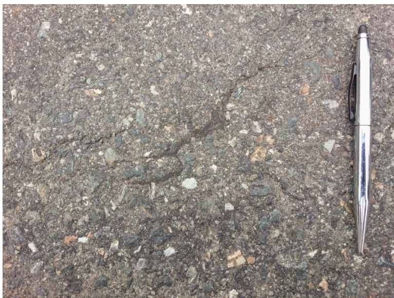
写真 6.7 供用 11 年後の表面保護材の充填状況
