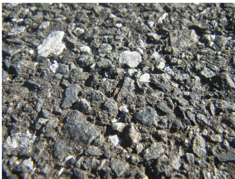
写真 5.13 劣化・老化が進行した舗装路面の状態
