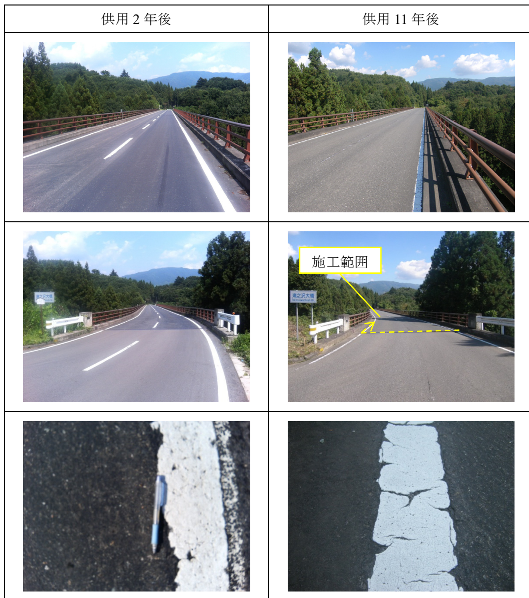
写真 6.6 調査箇所 B における供用後の路面写真
