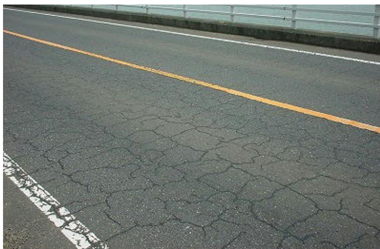
写真 1.1 アスファルト舗装の劣化・老化による損傷 20)
