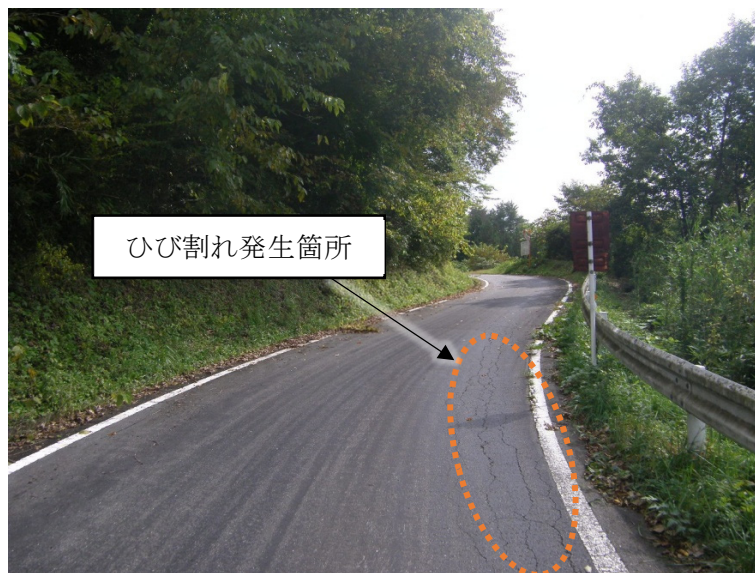
写真 6.11 ひび割れ発生箇所付近の状況
