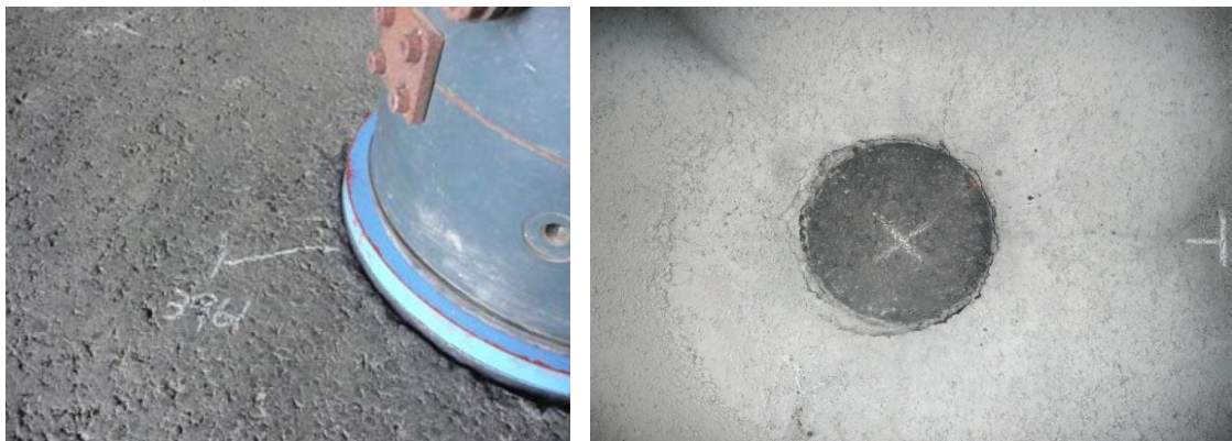
写真 5.16 微細なひび割れの発生状況 1)
