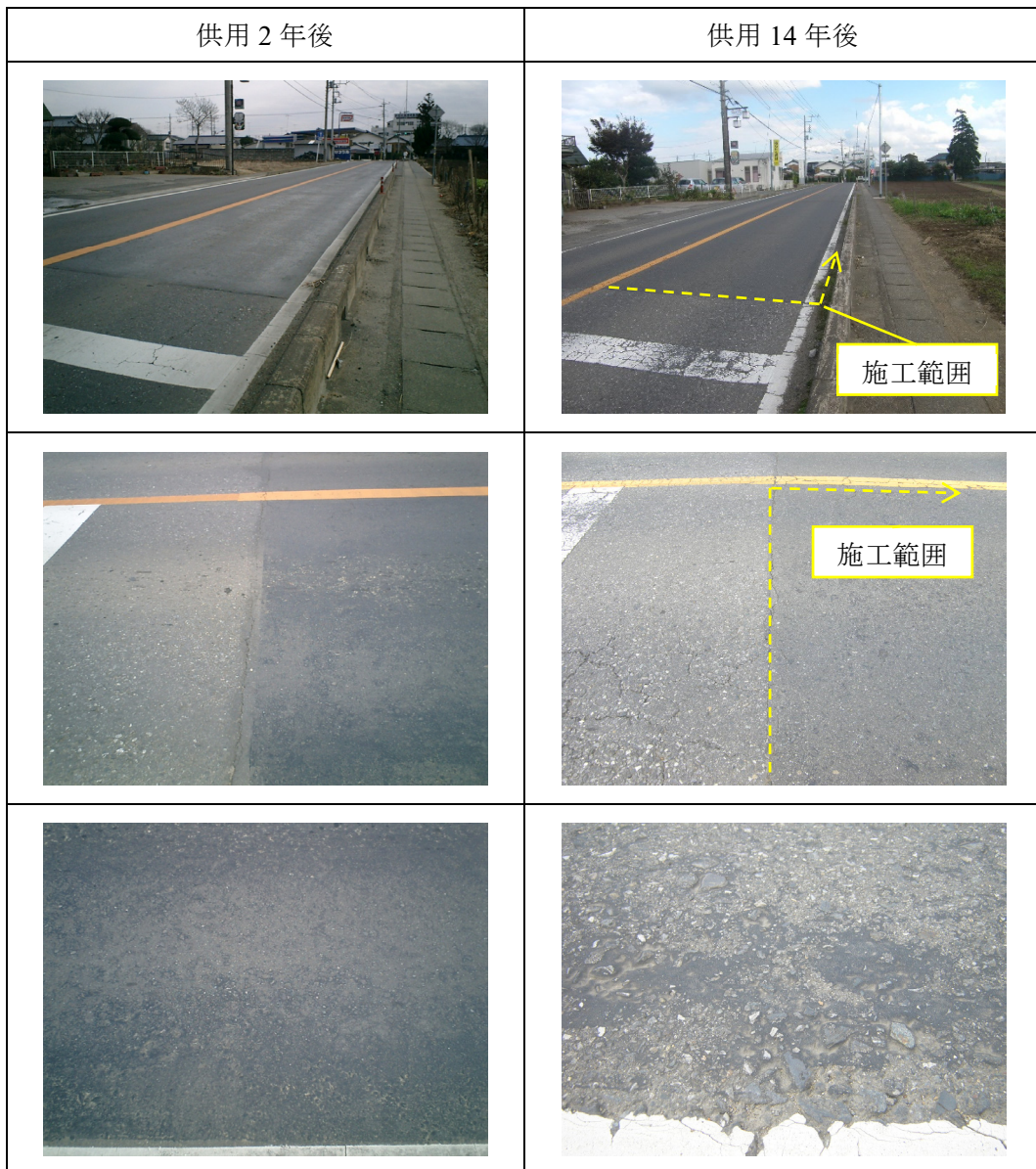
写真 6.3 調査箇所 A における供用後の路面写真
