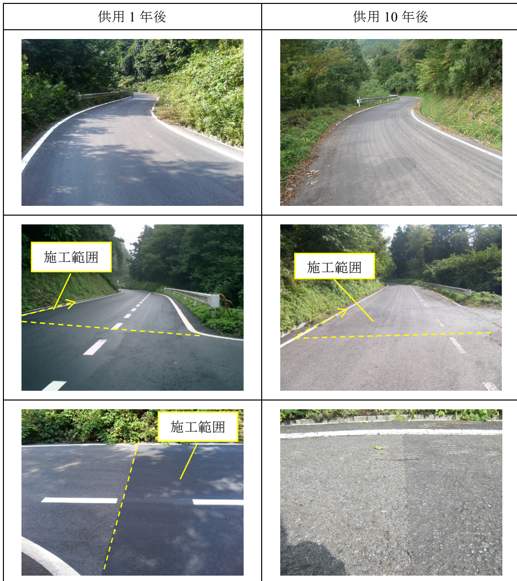
写真 6.9 調査箇所 C における供用後の路面写真
