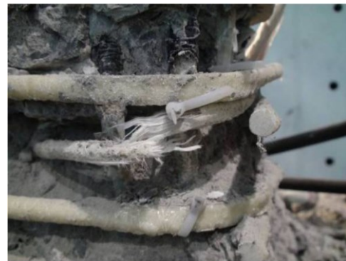
(b) GFRP stirrups cut
