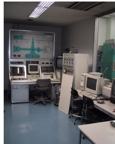
(b) コントロールルーム
