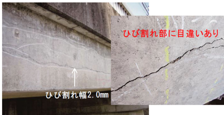
図1.33 主桁側面のひび割れ状況 27)
