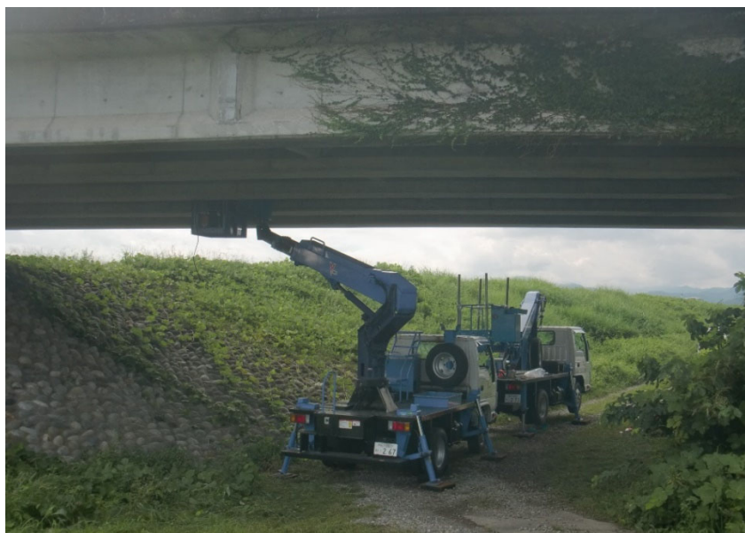
図 3.51 センサ設置状況
