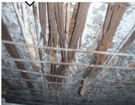
図 1.22 妙高大橋の損傷事例 12)
