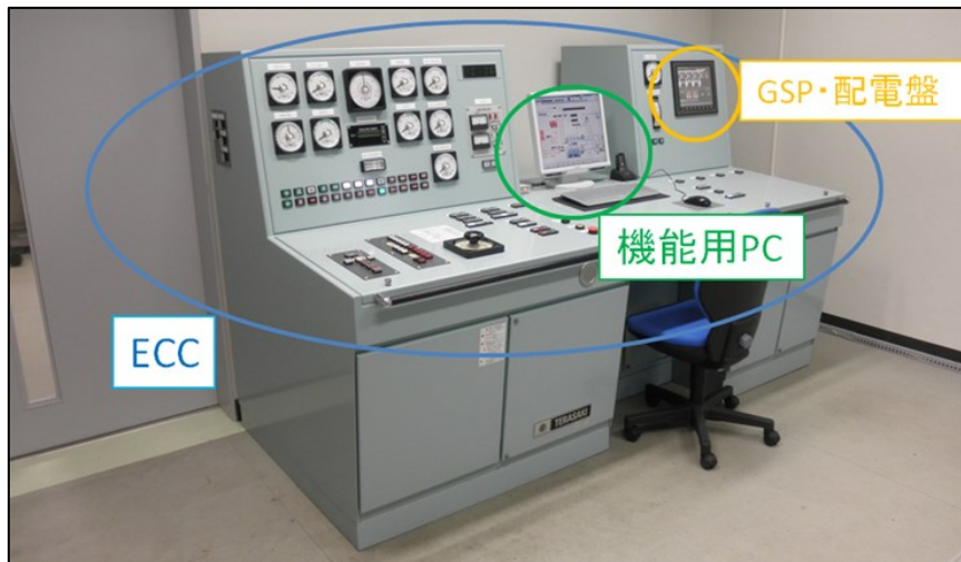
Fig. 3.4 MEPS 機関制御設備
