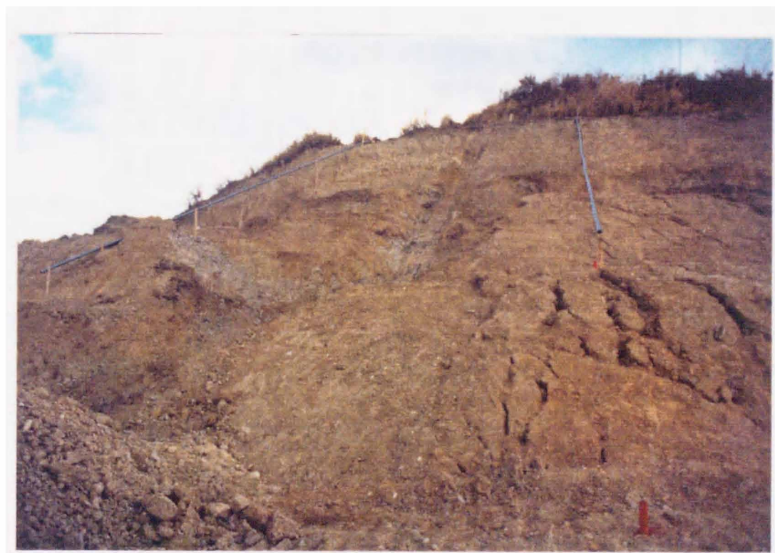
写真-2.5 崩壊した試験斜面の法尻部の上砂隆起状況
