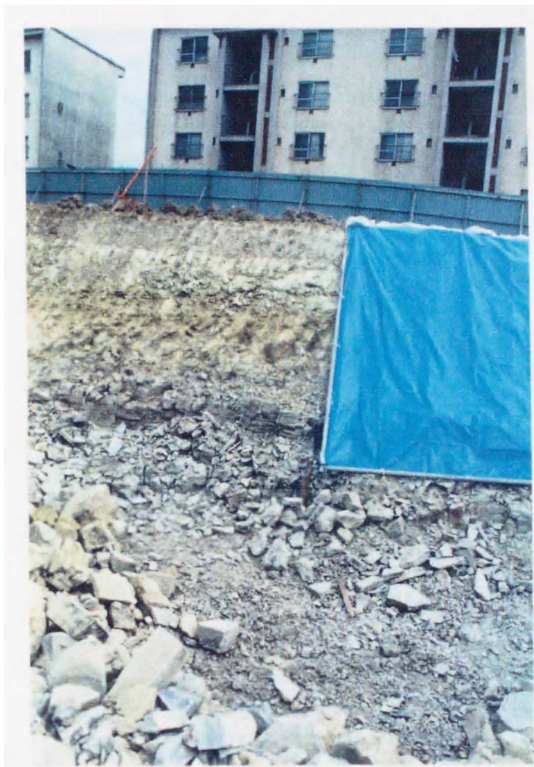
写真-4.3 凝灰岩の風化状況
