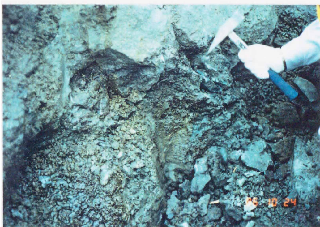
写真-5.4 すべり面となる泥岩層の脆弱化した粘土層
