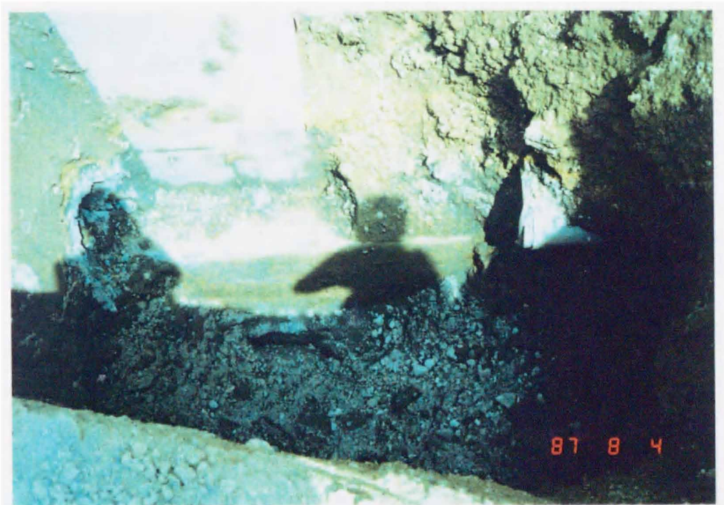
写真-5.3 ポンプ場躯体埋戻し土の沈下によるアンダードレーン管の破壊及び礫岩に発生した亀裂の状況
