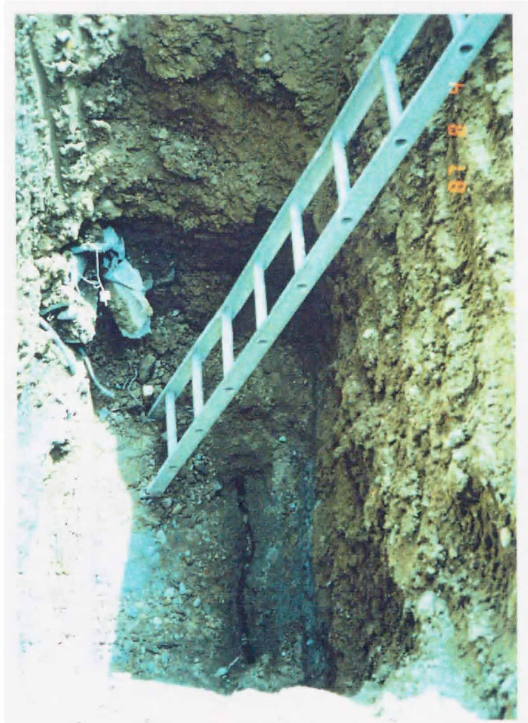
写真-5.2 ポンプ場躯体近傍に発生した引張り亀裂の状況
