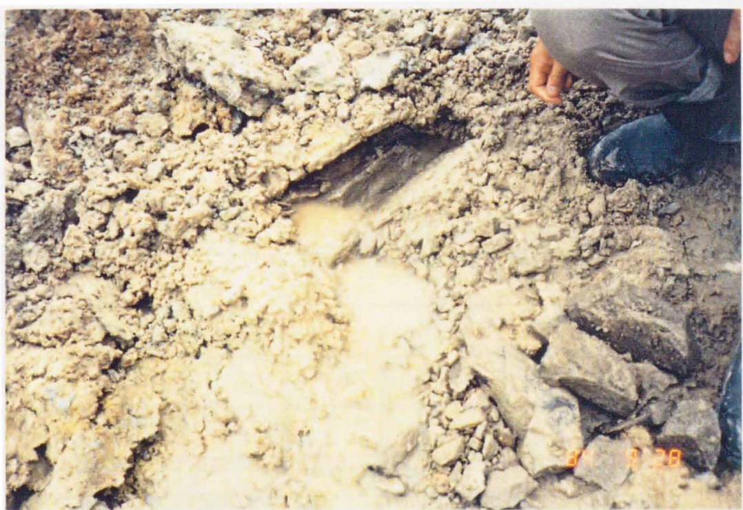
写真-4.6 凝灰岩層中の亀裂からの地下水の流出状況
