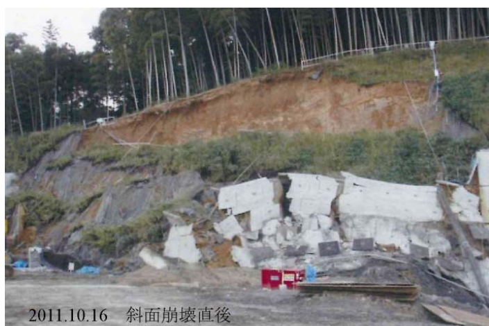
写真-5.1 仮設斜面の崩壊状況
