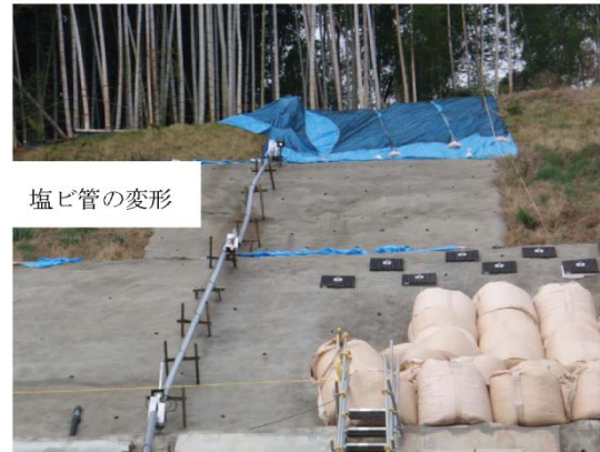
写真-5.3 B 斜面変状の状況
