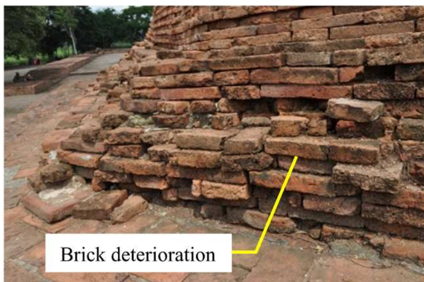
図 7.6 北側基礎部のレンガの破壊状況（2019年8月20日撮影）
