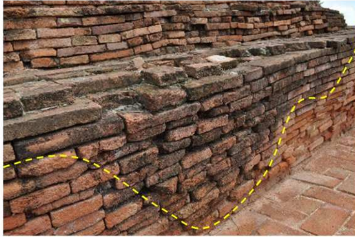
図 7.7 雨水の流水跡とレンガの劣化状況（2019 年 8 月 20 日撮影）
