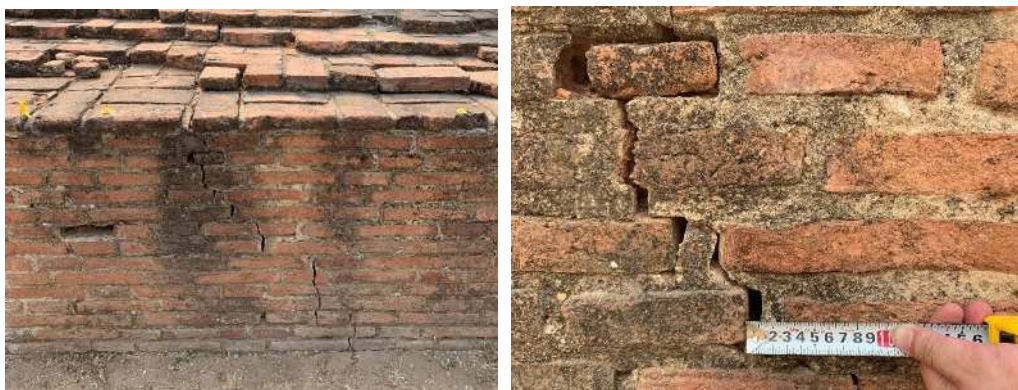
図 7.5 土台南側の目地部に生じたクラック（2020年2月29日撮影）
