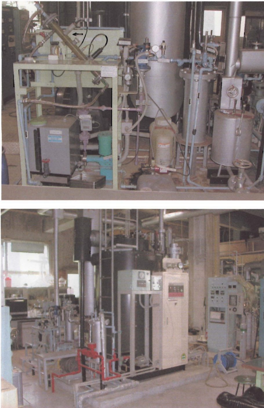
図 10.1 混入海水によるボイラ水質の挙動調査の実験 (第3章・第4章の実験装置)
