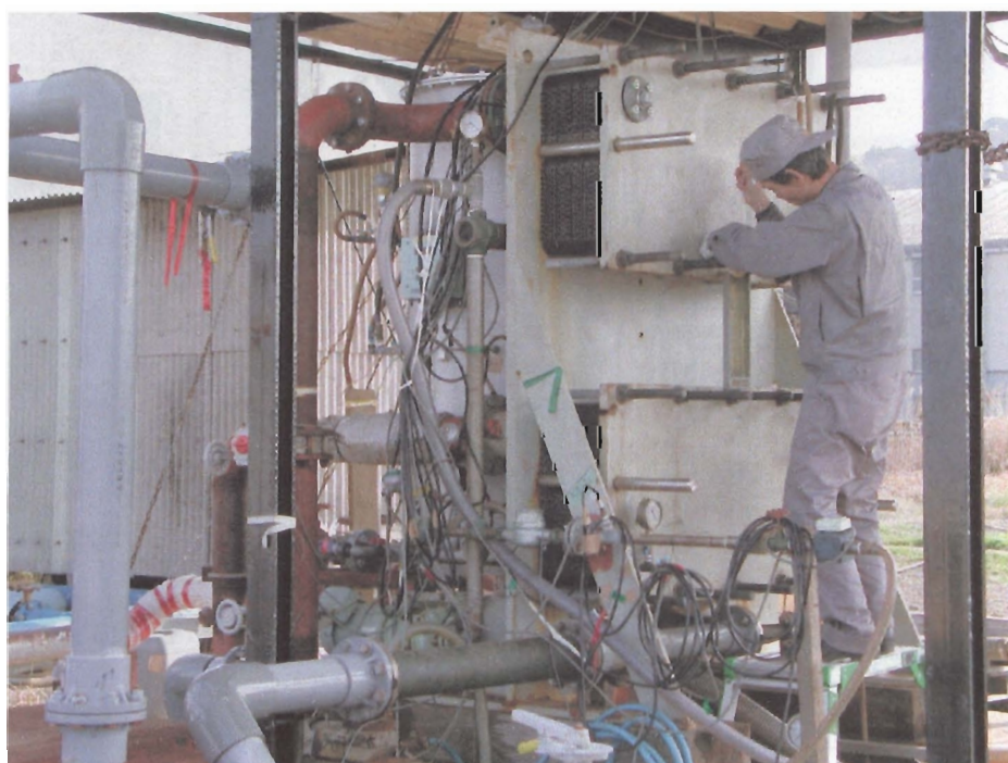
図 10.3 造水器を利用したボイラブロー水再生システム構築のための実験 (第9章の造水器)
